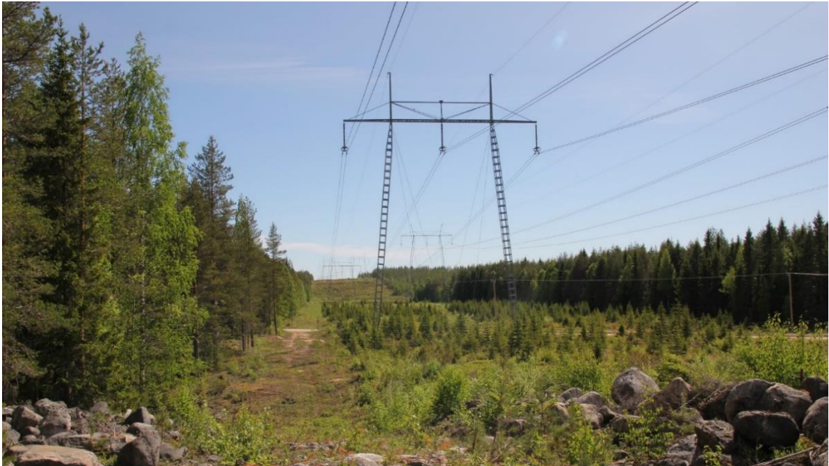
Kuva 14-1. Johtoaukea Konttilanperällä, kuvauskulma pohjoisesta etelään. Kuvassa Fingridin kaksi 400 kV:n voimajohtoa sekä vasemmassa reunassa moottorikelkkaura. Ollinkorven suunniteltu sähkönsiirtoreitti sijoittuisi johtokäytävän itäpuolelle, kuvassa vasemmalle puolelle.
